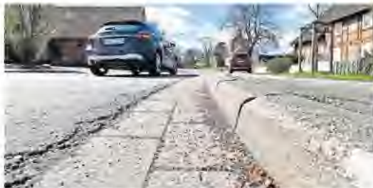
Unter anderem an der Kirchvordener Straße in Vöhrum lag das Granulat in der Gosse. FOTO: RALF BÜCKLER
